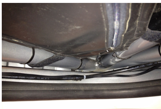
Εικόνα 30: Πέρασμα σωληνώσεων μεταξύ κλωβού και αμαξώματος
